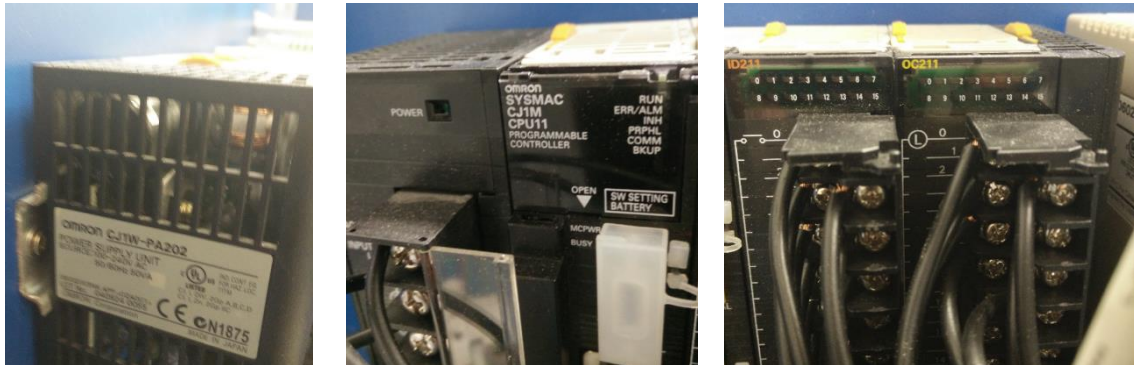
Fig. 68 Imágenes del PLC usado en el manipulador.
