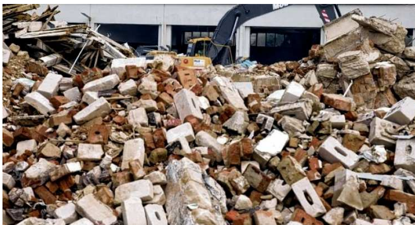
Fig. 23. Escombros tras la demolición de un edificio.
