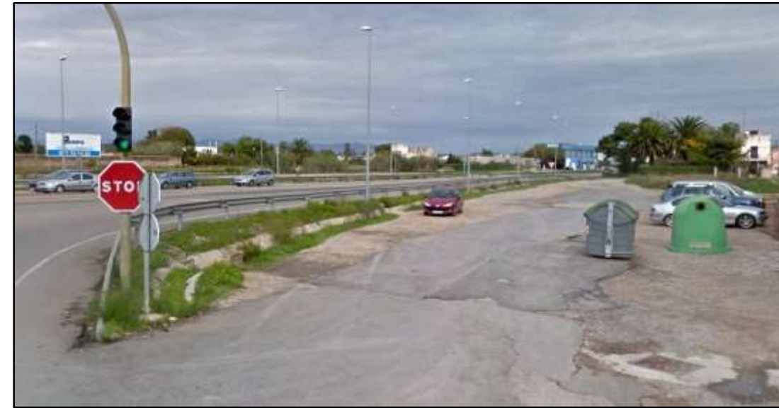
Figura 3.38 – Nulos espacios peatonales y firmes en un estado muy deficiente en las actuales vías de servicio. Fuente: elaboración propia.
