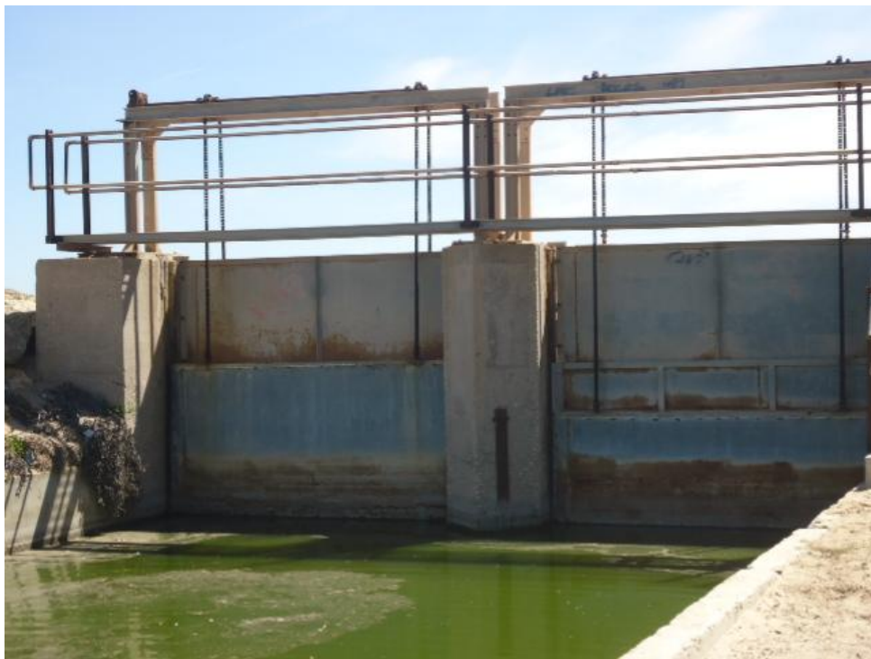
Figura 11. Compuerta acequia de la Ratlla. Elaboración Propia
