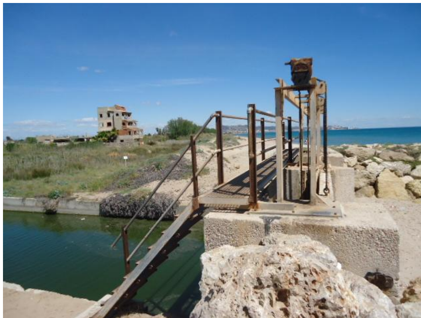
Figura 26. Estado actual de la acequia. Elaboración propia
