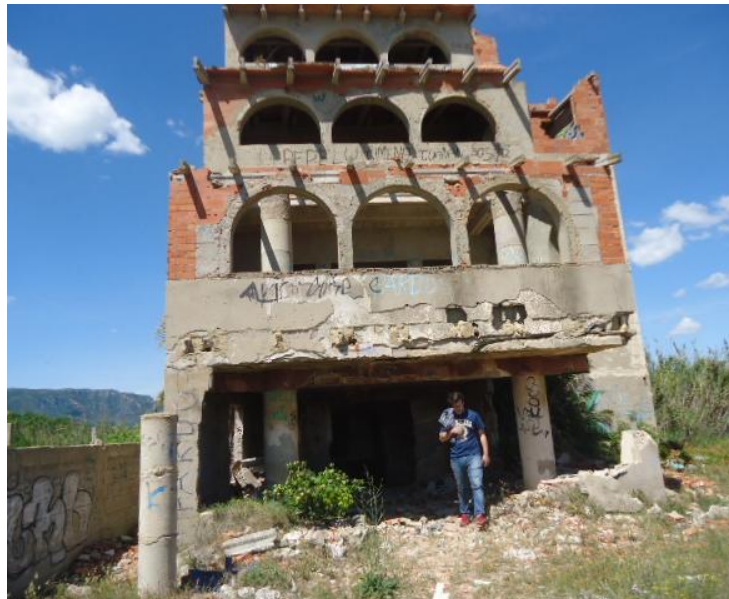
Figura 27. Edificio abandonado. Elaboración propia
