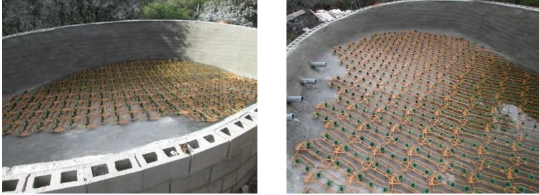
Figura 12 Depuradora de macrofitas para vivienda en Torrelodones
