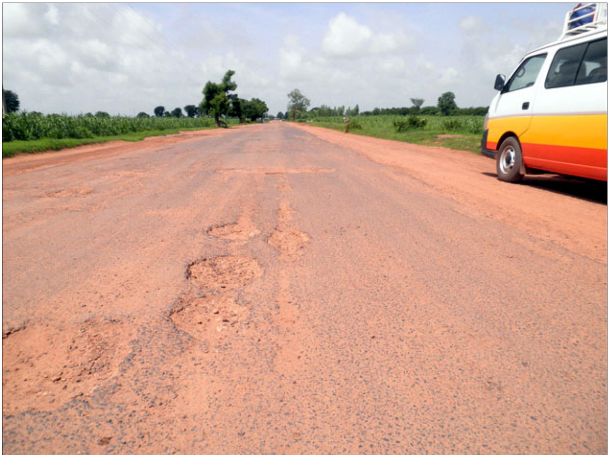
carreteras en mal estado en Senegal.
