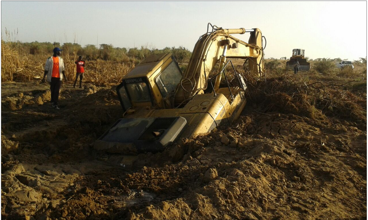
terreno impracticable y paralización de los trabajos.
