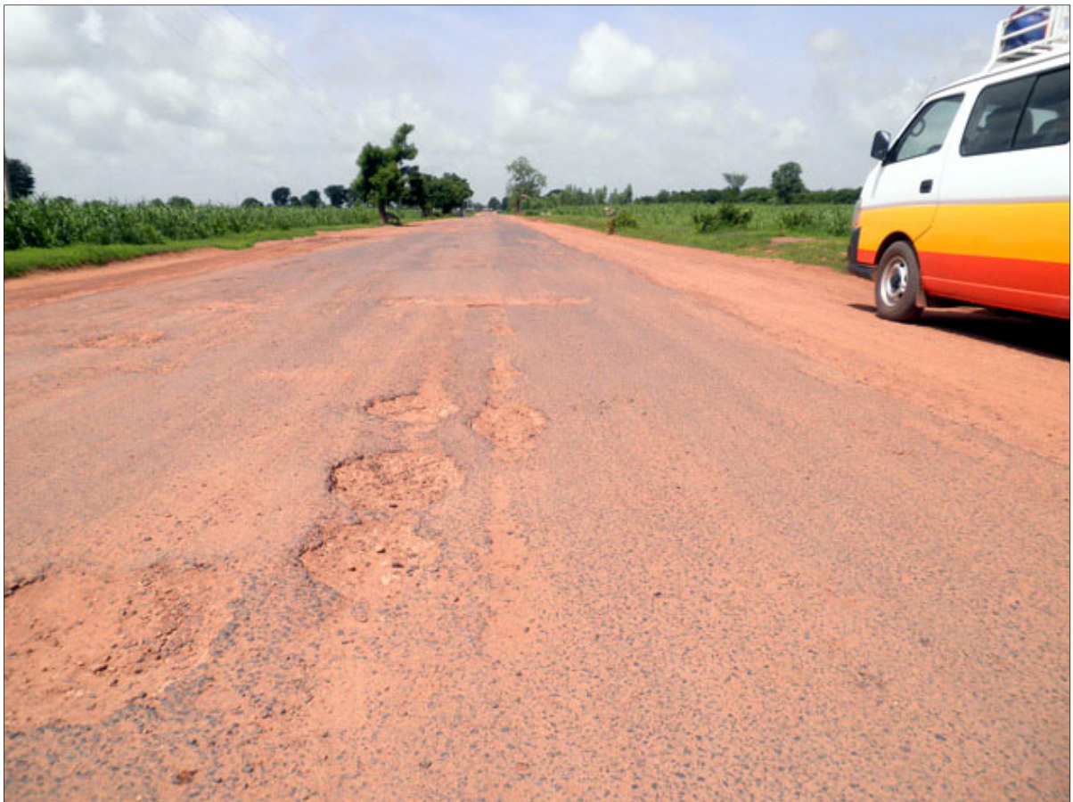
carreteras en mal estado en Senegal.
