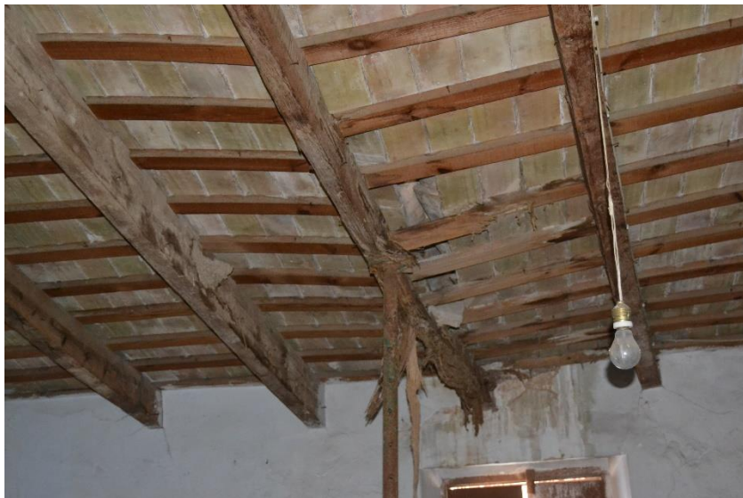
Figura 37. Estado actual de la cubierta delantera (Alejandro Serra 2016).
