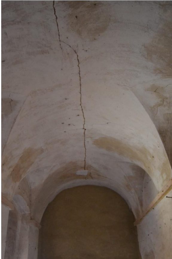
Figura 36. Grieta estructural en bóveda de cañón (Alejandro Serra 2016).
