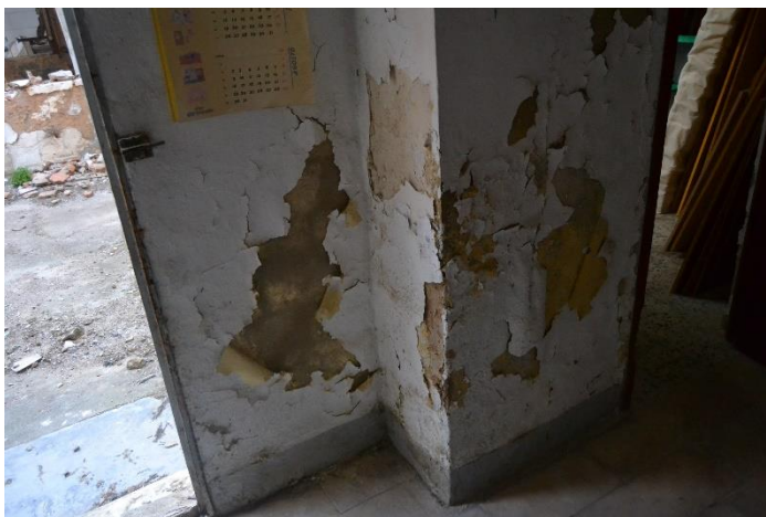
Figura 40. Humedad por capilaridad (Alejandro Serra 2016).
