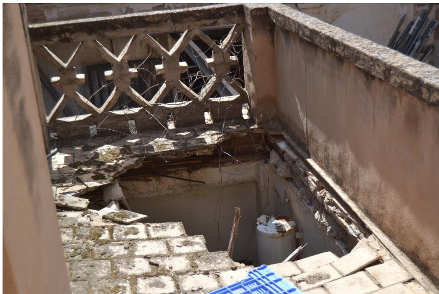
Figura 38. Estado actual azotea de nueva construcción (Alejandro Serra 2016).
