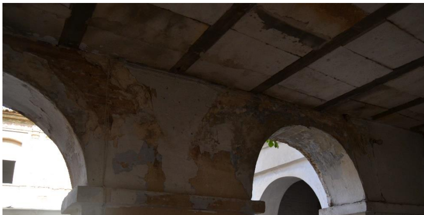
Figura 41. Humedad por filtración (Alejandro Serra 2016).
