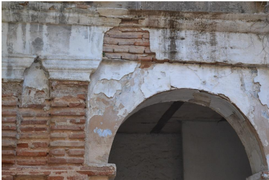
Figura 39. Pérdida de revestimiento en los muros (Alejandro Serra 2016).
