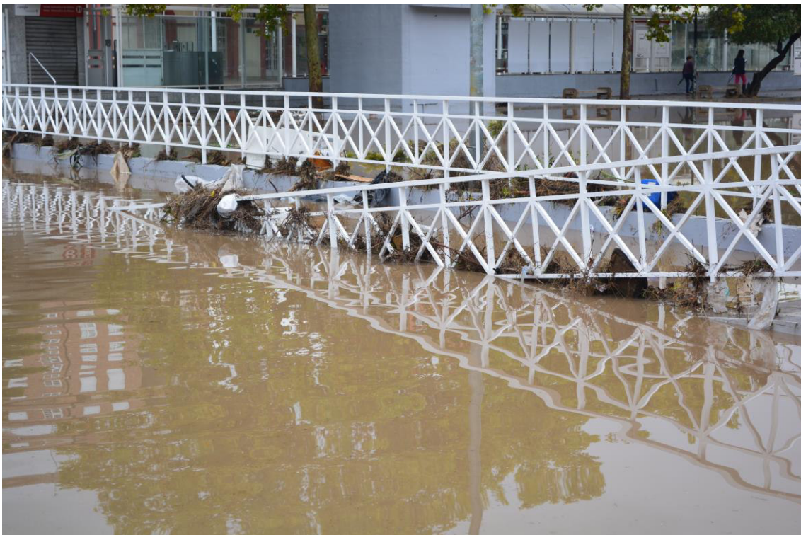
Figura 8.3. Transporte de residuos a causa de la fuerza del agua.
