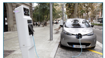
ILUSTRACIÓN 93 - RENAULT ZOE EN OPERACIÓN DE CARGA EN ESTACIÓN
