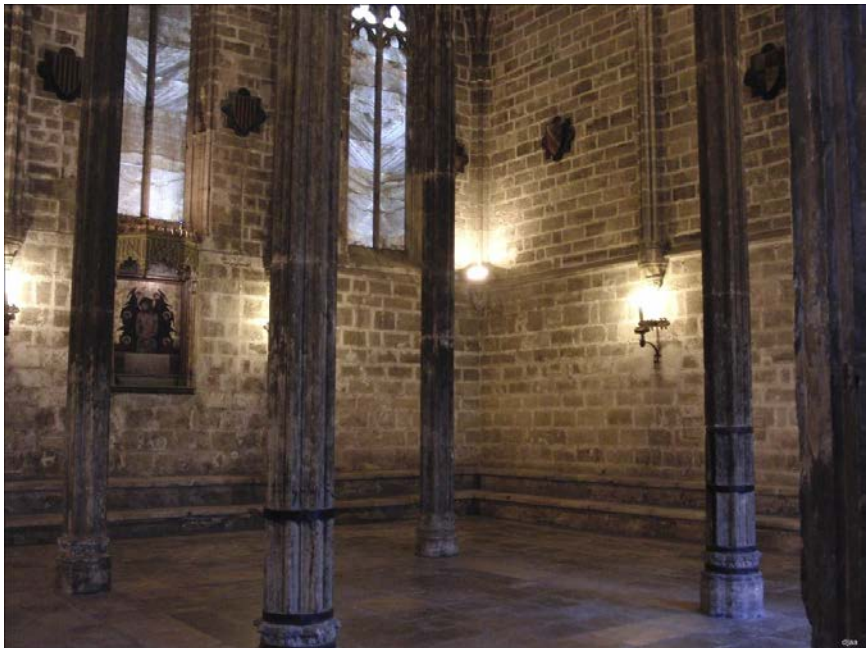
Figura 69. Imagen de las columnas empresilladas con piezas de hierro forjado. 2016. Web: jdiezarnal.com
