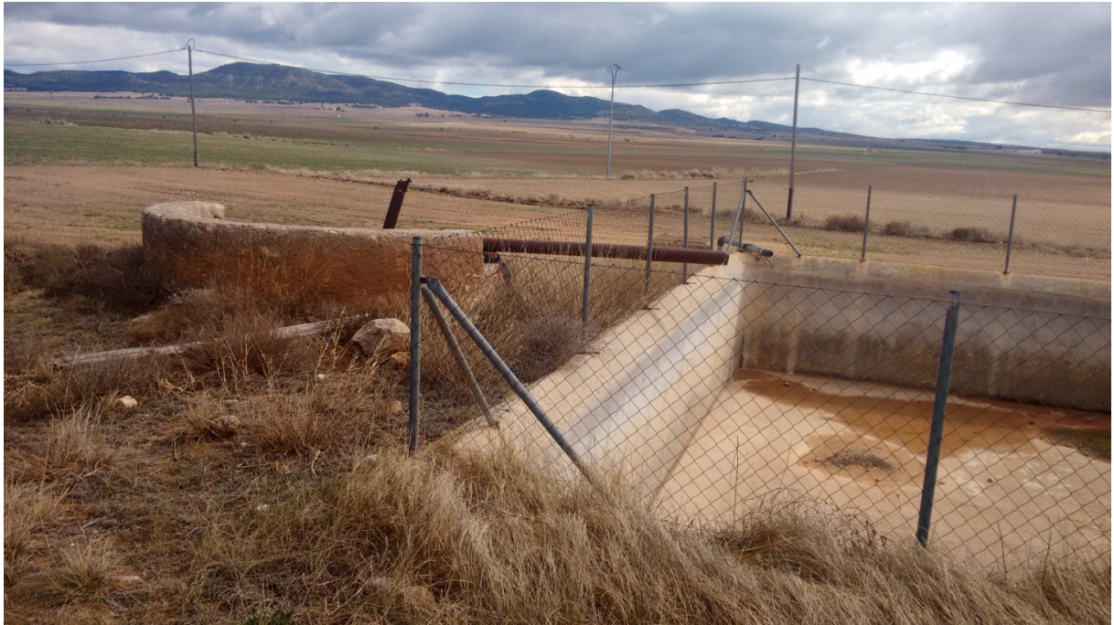
Foto4: Uno de los numerosos pozos de riego existentes y balsa de regulación
