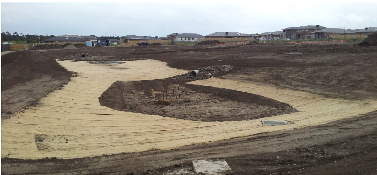
Fig. 38. Vaso de inundación regularizado y desbrozado, con aporte de tierra vegetal en las zonas a sembrar. Fuente: Programmed property services (AU)
