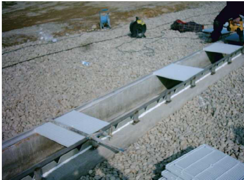
Fig. 37. Instalación de canal de vertido de entrada a un humedal existente con tapas de protección y vertedero continuo thompson en material plástico. Fuente: Generalitat de Catalunya, Departament de Territori i Sostenibilitat
