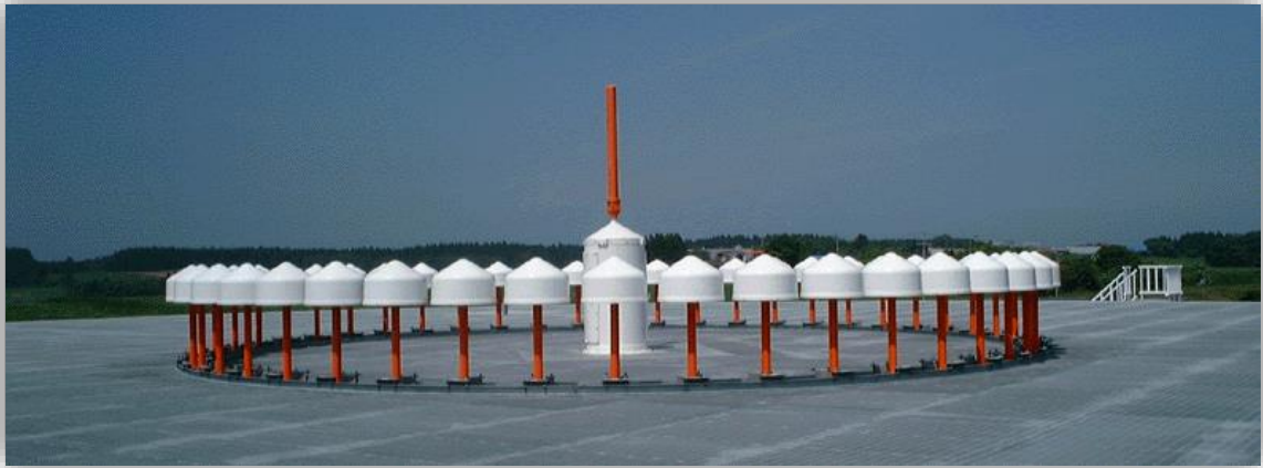
Ilustración 30: Infraestructura de un VOR/DME
