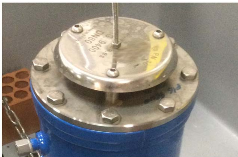
Figura 3.7.- Detalle Inmovilización del flotador por varilla roscada.
