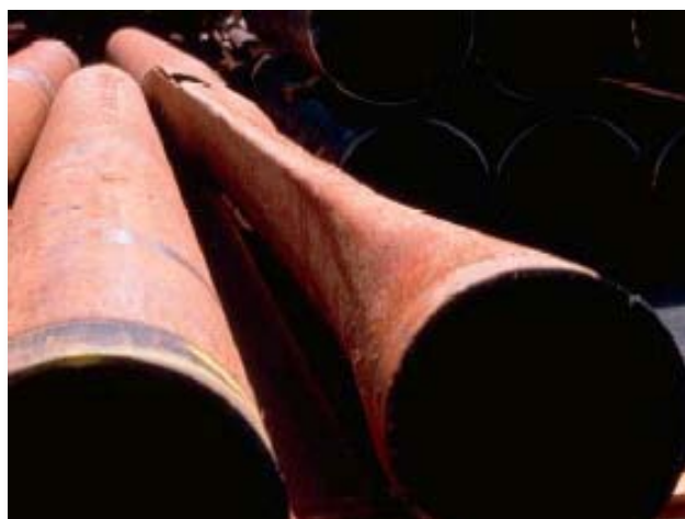
Figura 1.3.- Colapso de tubo de acero, consecuencia de la depresión soportada.
