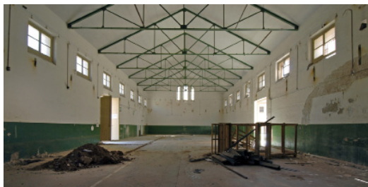
Figura 12. Estado en el que se encontraba la nave norte.
