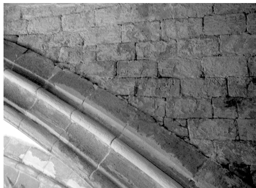
Detalle de la plementería tabicada de la nave de la Colegiata de Gandía (a partir de 1386). Foto Arturo Zaragoza.
