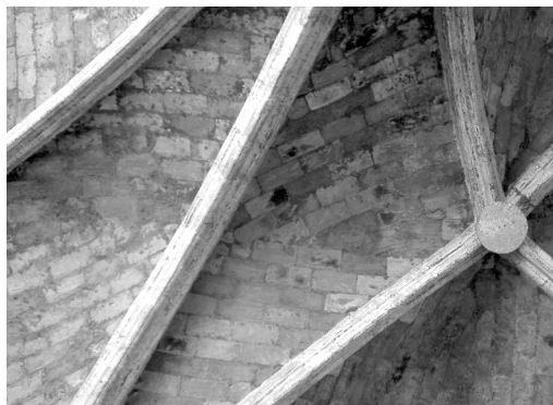
Detalle de la bóveda de la panda sur del claustro de Santo Domingo de Valencia (antes de 1368).
