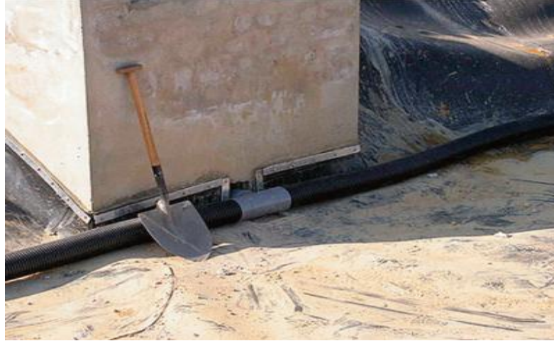
Figura III. 58: Enlace de las tuberías de drenaje con la tubería de evacuación a través del fondo de la arqueta de salida (Manual de Tecnologías no Convencionales para la Depuración de Aguas Residuales).
