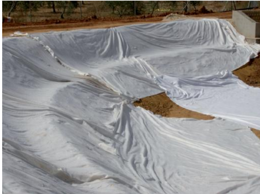
Figura III. 27: Colocación de la lámina de geotextil en una laguna facultativa y de maduración (Manual de Tecnologías no Convencionales para la Depuración de Aguas Residuales).
