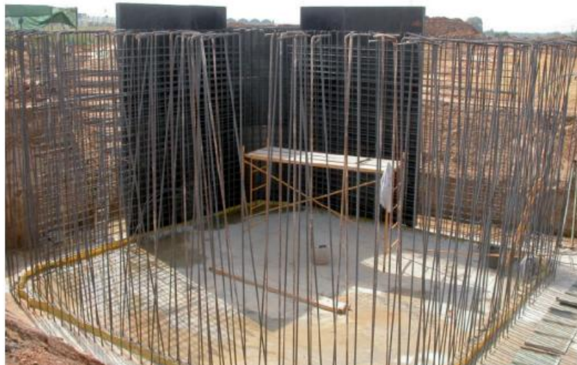
Figura III. 16: Colocación del encofrado en una laguna anaerobia (Manual de Tecnologías no Convencionales para la Depuración de Aguas Residuales).
