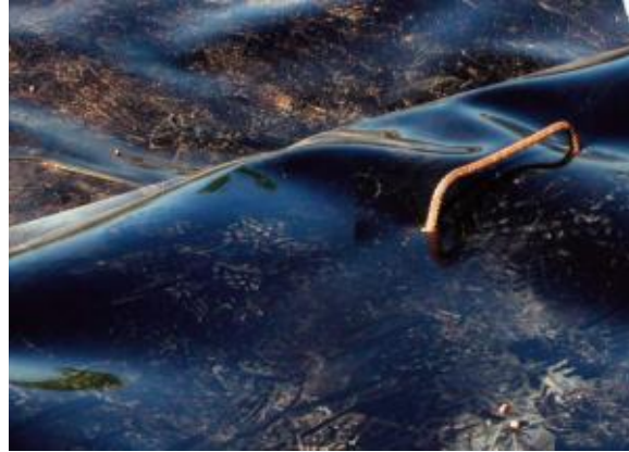
Figura III. 55: Sujeción de la lámina plástica mediante grapa metálica (Manual de Tecnologías no Convencionales para la Depuración de Aguas Residuales).
