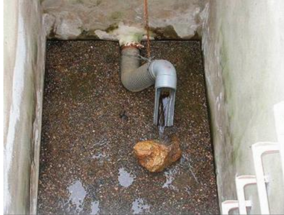
Figura III. 60: Tubería de evacuación de efluentes, conectada a las tuberías de drenaje (permite controlar el nivel del agua en el sustrato filtrante (Manual de Tecnologías no Convencionales para la Depuración de Aguas Residuales).
