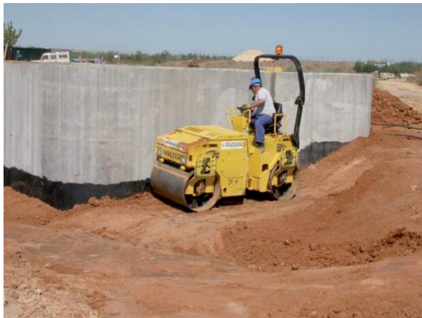
Figura III. 22: Relleno y compactación del terreno circundante en una laguna anaerobia (Manual de Tecnologías no Convencionales para la Depuración de Aguas Residuales).
