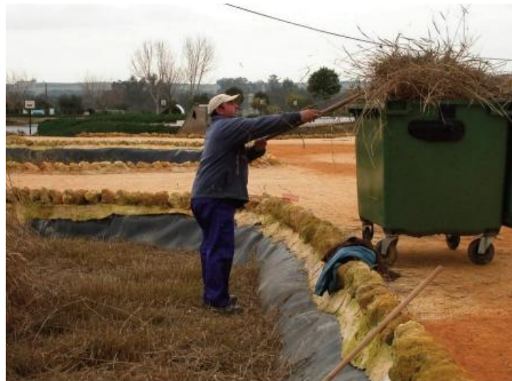
Figura III. 72: Evacuación de la biomasa seca tras la siega de un humedal (Manual de Tecnologías no Convencionales para la Depuración de Aguas Residuales).
