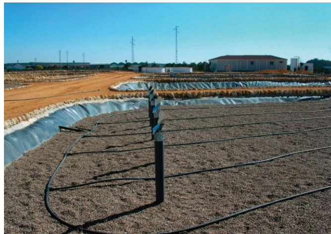
Figura III. 65: Detalle de las chimeneas de ventilación en un HAFSs vertical (Manual de Tecnologías no Convencionales para la Depuración de Aguas Residuales).
