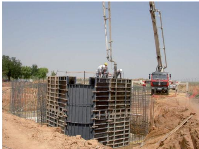
Figura III. 18: Hormigonado de las paredes en una laguna anaerobia (Manual de Tecnologías no Convencionales para la Depuración de Aguas Residuales).
