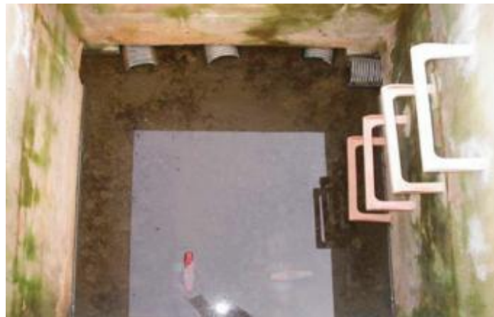
Figura III. 63: Detalles de las tuberías de evacuación de efluentes en la arqueta de salida (Manual de Tecnologías no Convencionales para la Depuración de Aguas Residuales).
