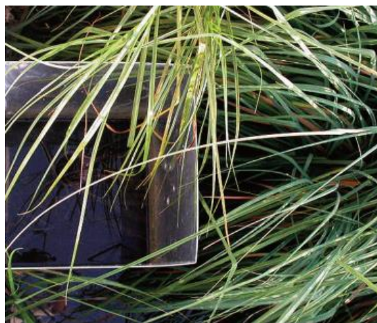
Figura III. 56: Chapa deflectora en la salida de un humedal de flujo superficial (Manual de Tecnologías no Convencionales para la Depuración de Aguas Residuales).
