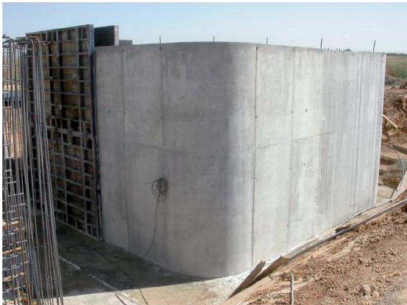
Figura III. 20: Encofrado del resto de la laguna anaerobia (Manual de Tecnologías no Convencionales para la Depuración de Aguas Residuales).
