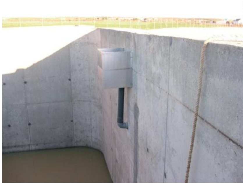
Figura III. 23: Vertedero de salida de una laguna anaerobia (Manual de Tecnologías no Convencionales para la Depuración de Aguas Residuales).
