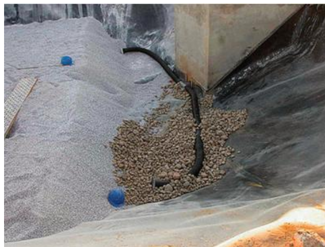
Figura III. 57: Tuberías de drenaje para la evacuación de efluentes en HAFSs horizontales. Las tuberías quedan embutidas en una capa de bolos de 50-100 mm (Manual de Tecnologías no Convencionales para la Depuración de Aguas Residuales).
