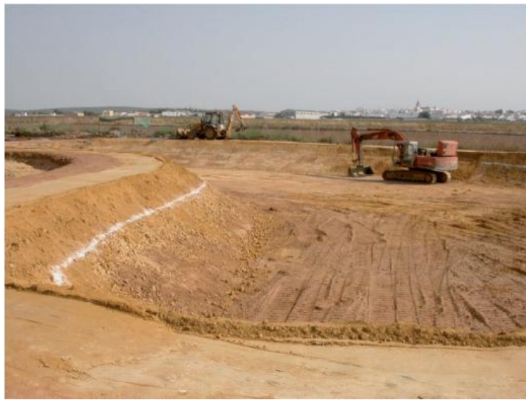
Figura III. 24: Excavación del confinamiento en una laguna facultativa y de maduración (Manual de Tecnologías no Convencionales para la Depuración de Aguas Residuales).
