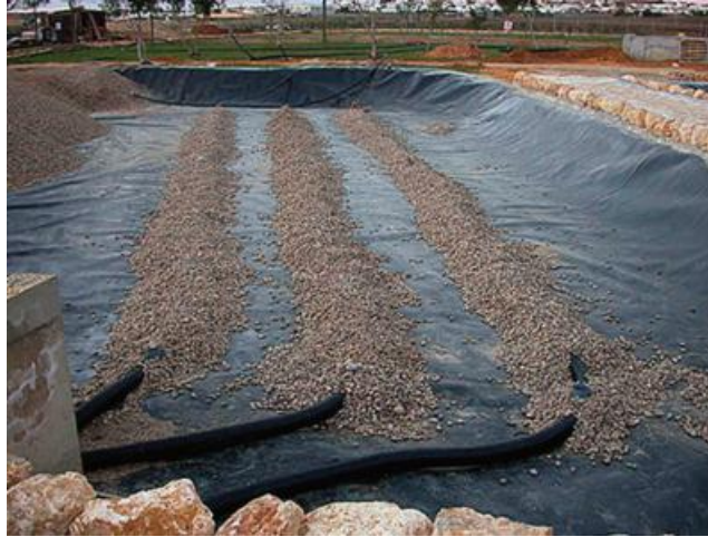
Figura III. 62: Las tuberías de drenaje se van cubriendo con una capa de grava de 25-40 mm (Manual de Tecnologías no Convencionales para la Depuración de Aguas Residuales).
