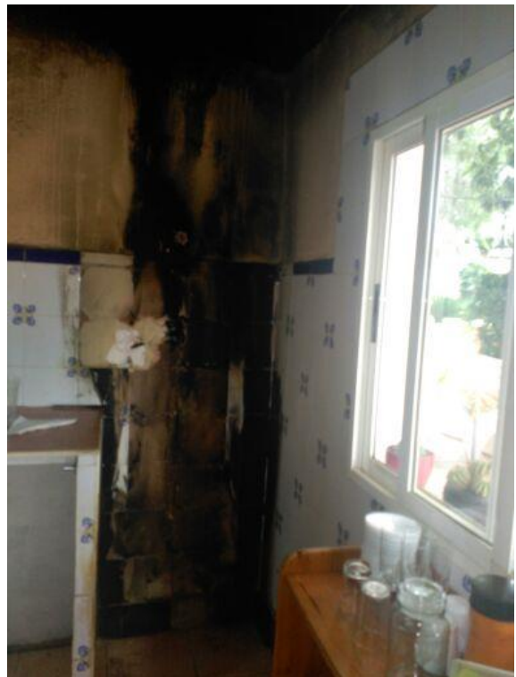
Ilustración 11. Ejemplo de origen de incendio/ Fuente propia
