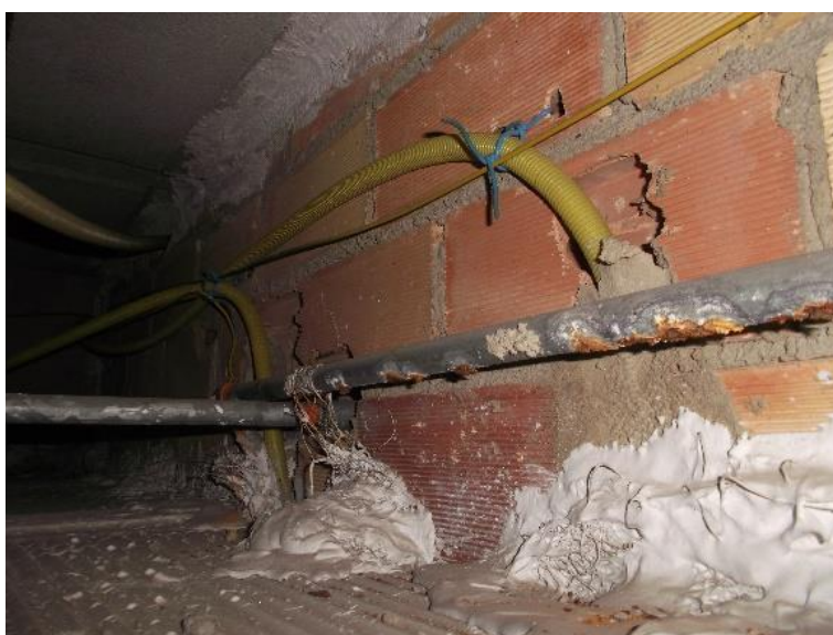
Ilustración 8. Ejemplo de tubería con corrosión generalizada/ Fuente propia
