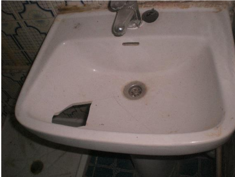
Ilustración 22. Ejemplo de rotura de loza/ Fuente propia
