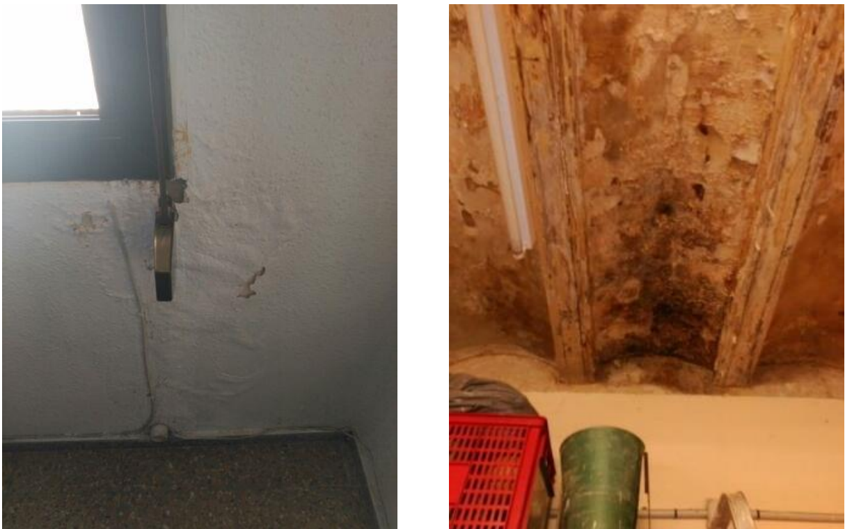
Ilustración 16. Ejemplo de filtraciones continuadas/ Fuente propia
