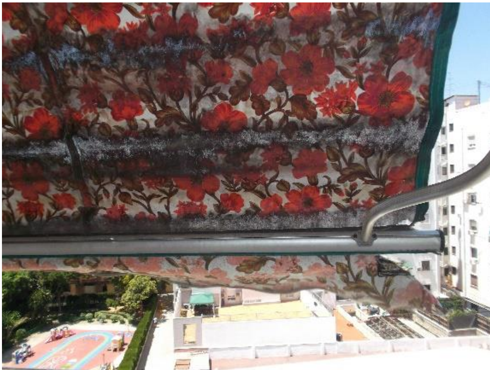
Ilustración 17. Ejemplo de toldo con falta de conservación/ Fuente propia
