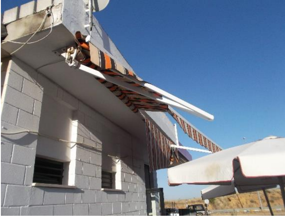
Ilustración 18. Ejemplo de daños en toldo causados por el viento/ Fuente propia
