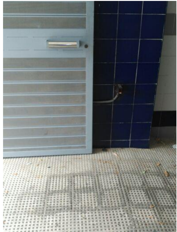
Ilustración 24. Ejemplo de puerta de garaje con protecciones interiores/ Fuente propia
