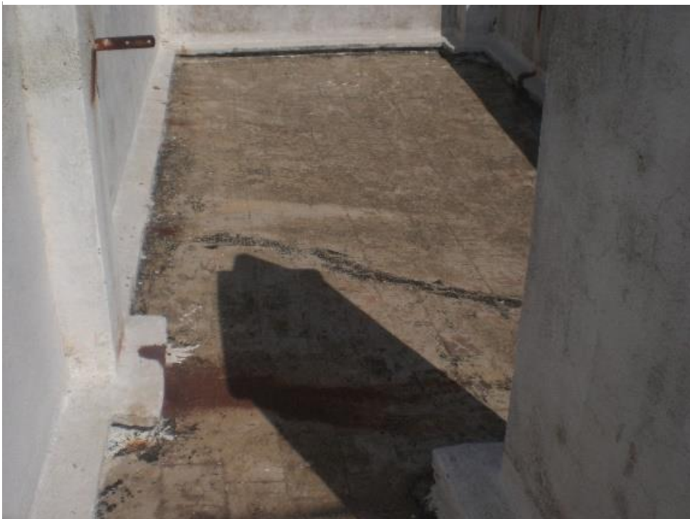
Ilustración 15. Ejemplo de cubierta con falta de conservación/ Fuente propia
