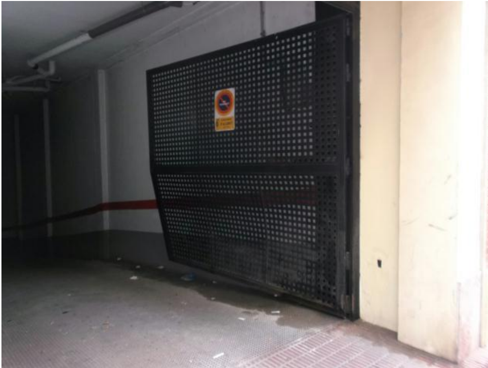
Ilustración 25. Ejemplo de puerta de garaje golpeada por vehículo/ Fuente propia
