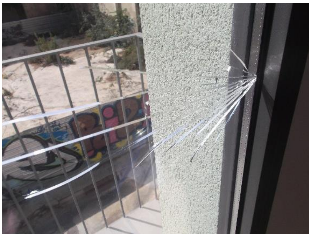
Ilustración 20. Ejemplo de cristal fracturado/ Fuente propia
