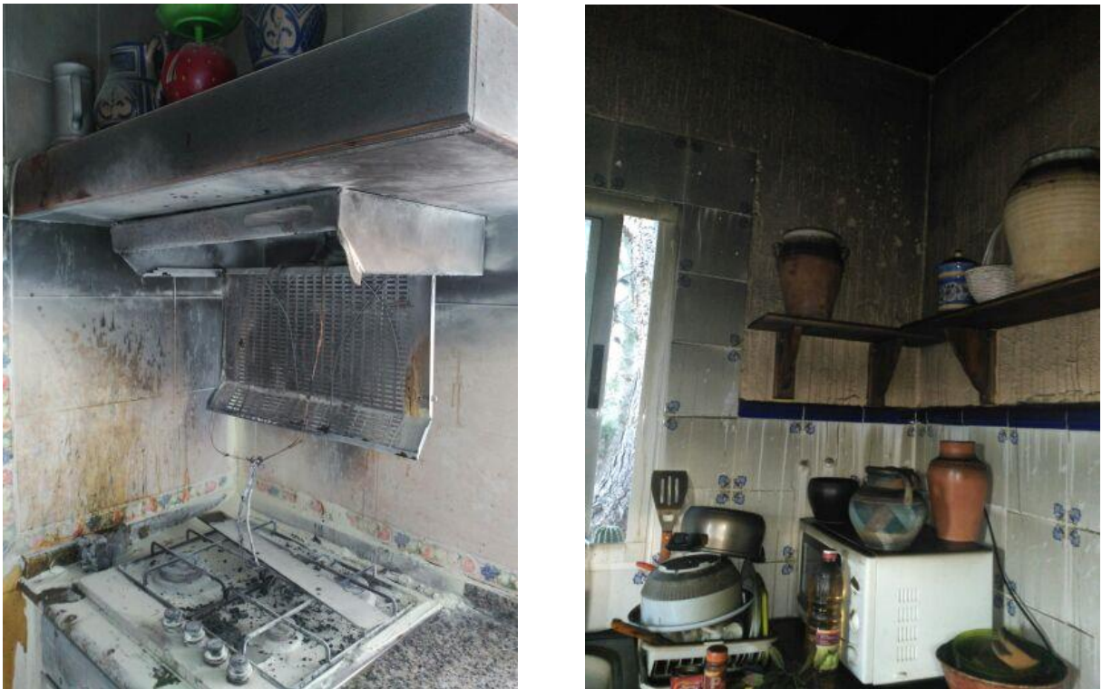
Ilustración 12. Ejemplo de daños causados por el hollín/ Fuente propia
