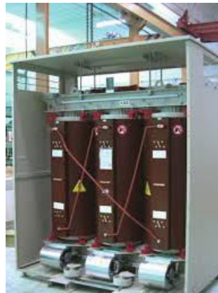
Figura 28: Transformadores de tipo seco encapsulado ABB IP 21
