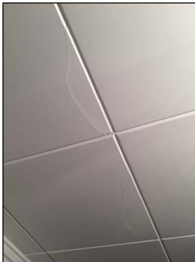
Ilustración 67: Grietas en escayola de techo. Fuente propia.
