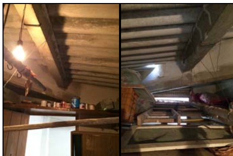
Ilustración 123: Cubierta actual placa ondulada de fibrocemento que sustituiremos chapa grecadaprelacada. Fuente propia.
