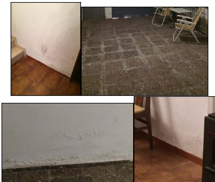
Ilustración 64: Humedades por capilaridad. Fuente propia.
