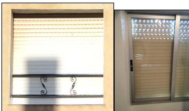
Ilustración 56: Ventana de aluminio y cristal simple situada en la habitación 4 de la vivienda (120x120cm). Fuente propia
