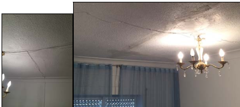
Ilustración 69: Pandeo forjado planta cubierta. Fuente propia.
