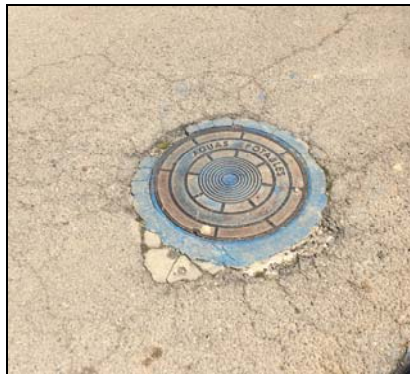
Ilustración 24: Pozo de saneamiento. Calle San Cristóbal. Fuente propia
