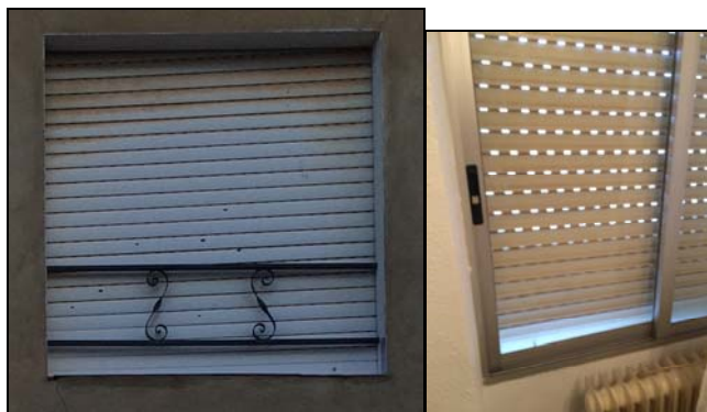
Ilustración 55: Ventana de aluminio y cristal simple situada en habitación 5 de la vivienda (120x120cm). Fuente propia
