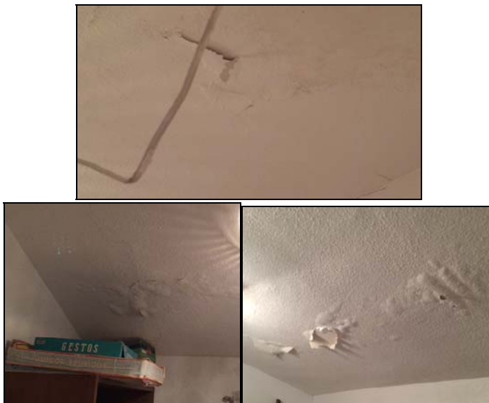
Ilustración 66: Desprendimiento enlucido de techo. Fuente propia.
