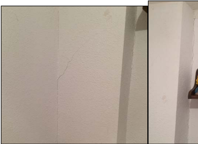
Ilustración 68: Grietas verticales en encuentro de tabique y pilar. Fuente propia.
