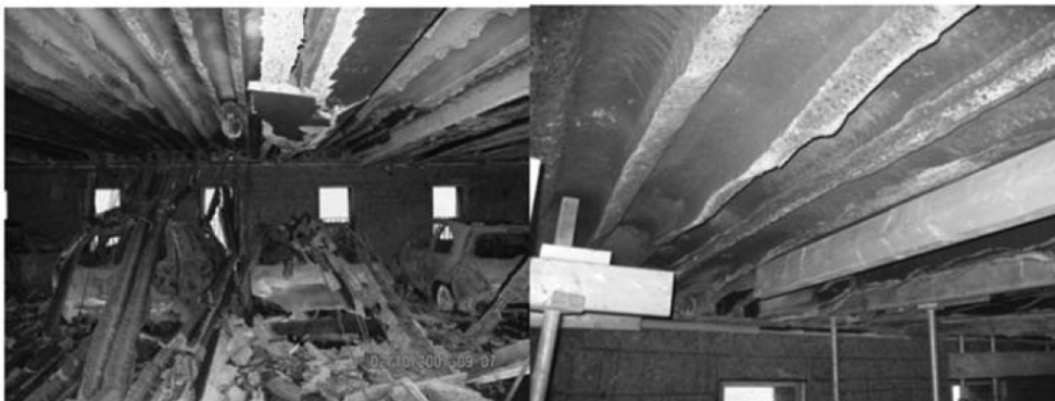
Fig. 5.38 Estado del forjado tras el incendio en el Edificio Harbour Edge (Rotterdam)
