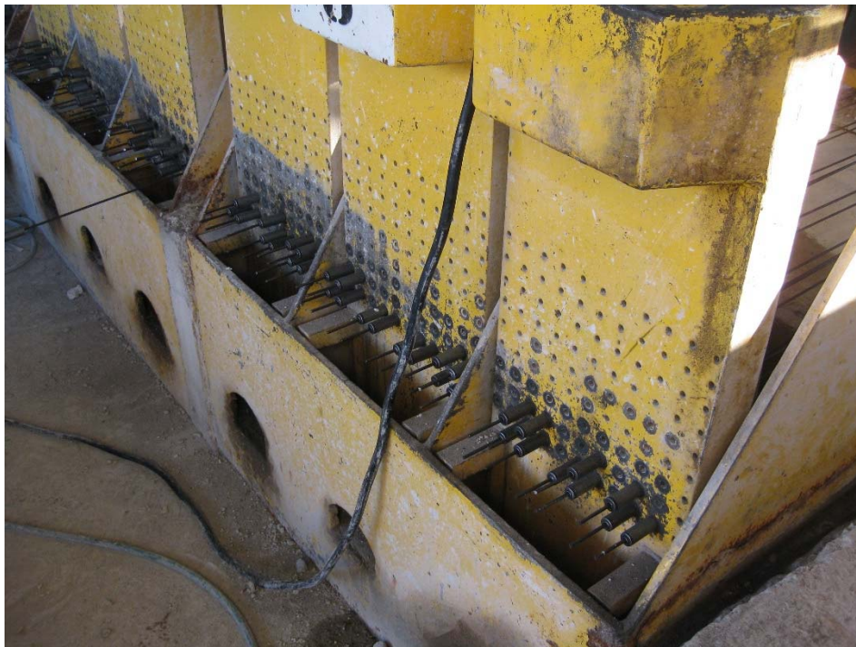
Fig. 3.5 Bancada de tesado con anclaje de tendones (Imagen cedida por HORVITEN VALENCIA, S.A)
