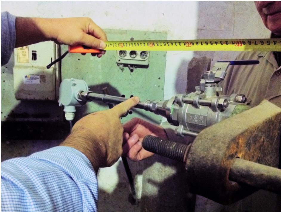
Figura 8: Instantánea tomada durante la instalación del caudalímetro intrusivo. Fuente: propia.
