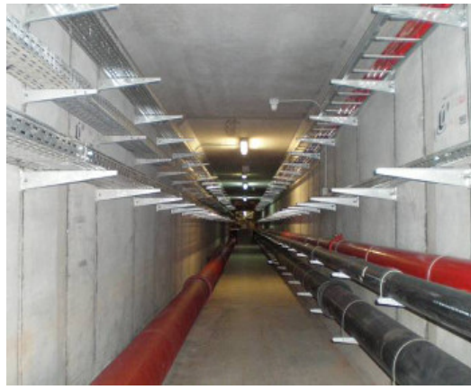
Figura 21. Galería de servicio. UJI.Castellón
