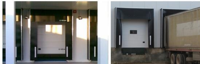
Ilustración 9 Características de muelles de carga y descarga frigoríficos
