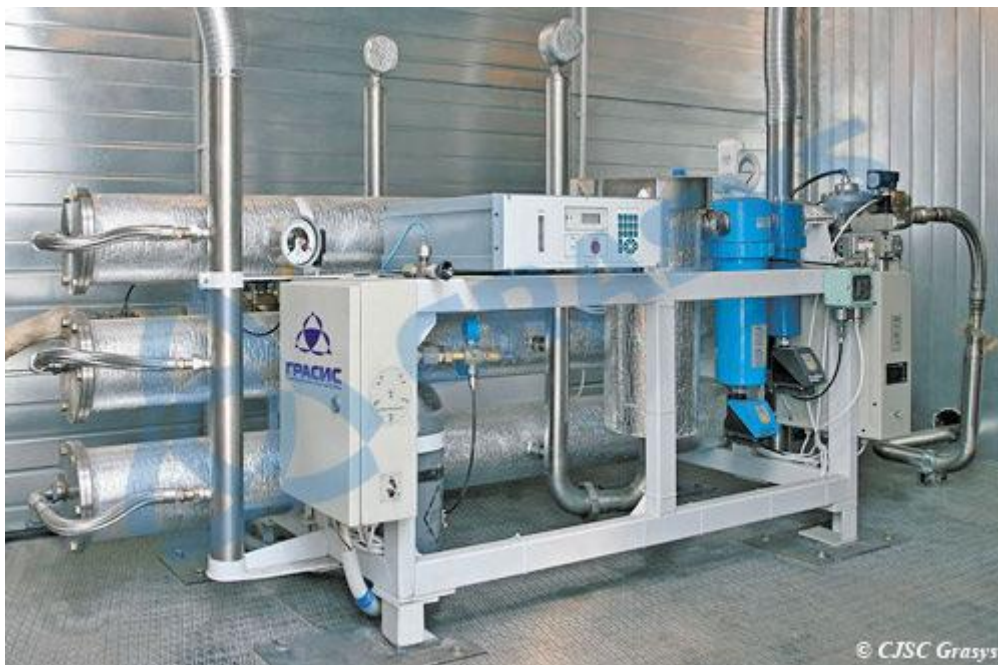
Figura 1. Instalación de aire enriquecido de oxígeno (Fuente: Grasy CJSC)
