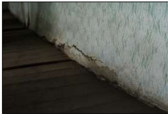
Imagen 3.10.- Daño en la base del muro Fuente: Propia
