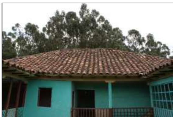
Imagen 3.20.- Elementos de cobertura sueltos. Fuente: Propia
