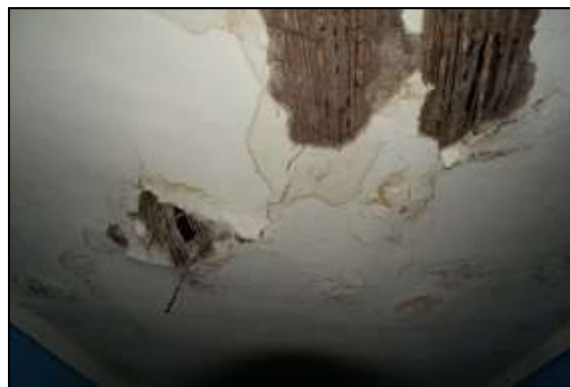
Imagen 3.23.- Carrizo con revoque de barro – daños por humedad. Fuente: Propia
