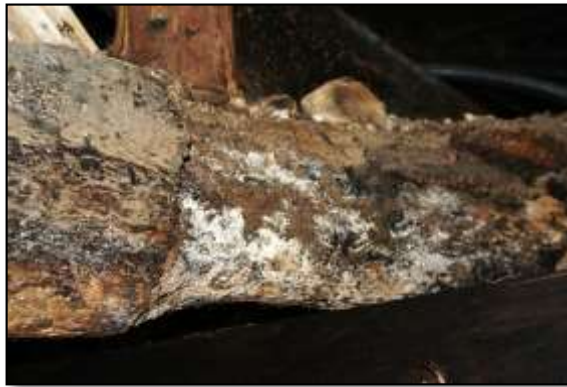
Imagen 3.19.- Pudrición en cabeza de viga. Fuente: Propia – Casa del arco
