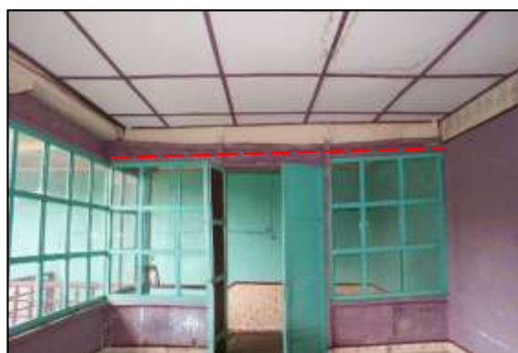
Imagen 3.21.- Deformación en elemento estructural. Fuente: Propia
