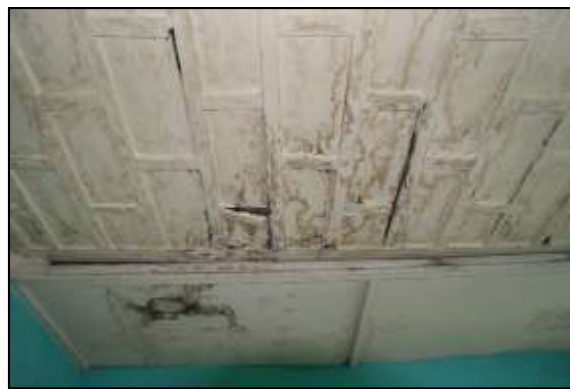
Imagen 3.22.- Tabla y tapajunta. – daños por humedad Fuente: Propia
