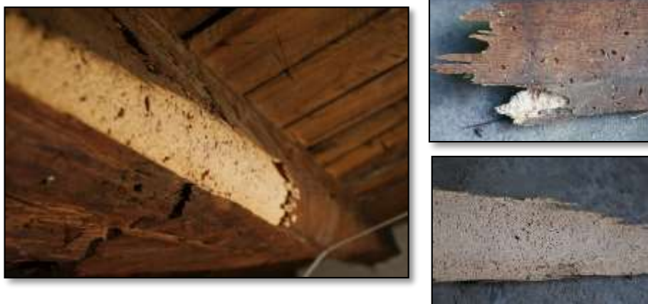
Imagen 3.18.- Viga con mayor humedad y presencia de carcoma Fuente: Propia
