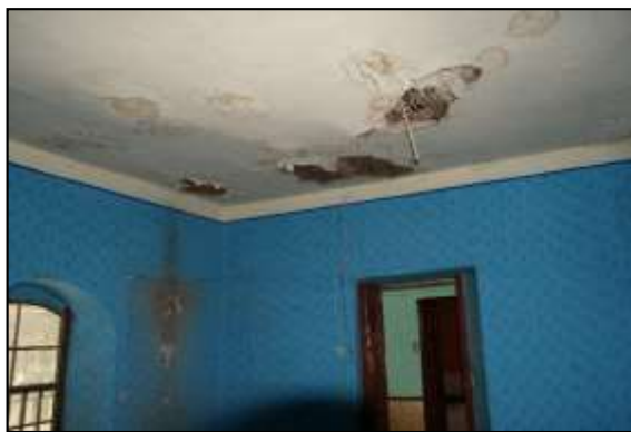
Imagen 3.15.- Daños en cielo raso por deterioro de cubierta Fuente: Propia
