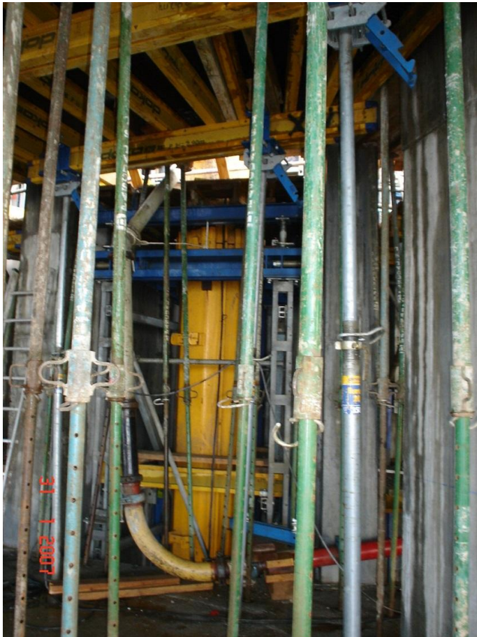
Ilustración 66 Tubería de bombeo dirigida al brazo distribuidor del hormigón.2006.Raúl López
