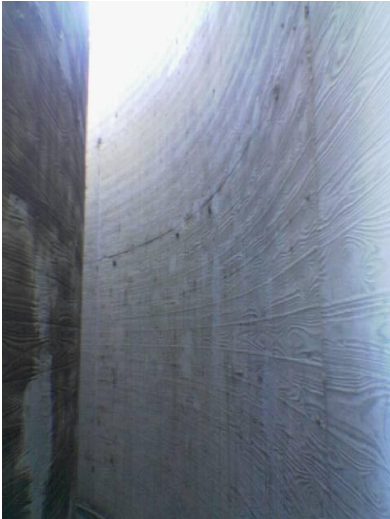
Ilustración 68 Madera encofrado deteriorado Autotrepa.2007.Raúl López
