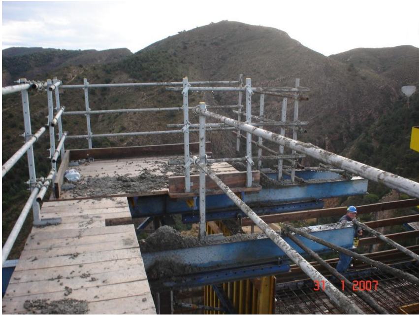
Ilustración 67 Falta de limpieza en los encofrados.2006.Raúl López
