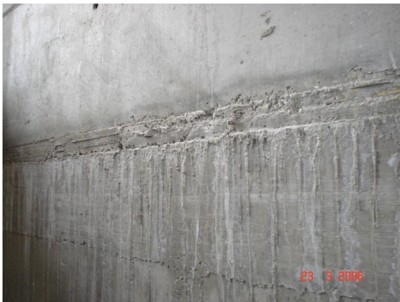
Ilustración 69 Pérdida de lechada de hormigón en junta de hormigonado.2006.Raúl López
