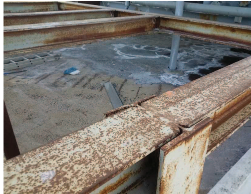
Ilustración 3. Estructura con pintura anticorrosiva oxidada. Fuente: Propia.
