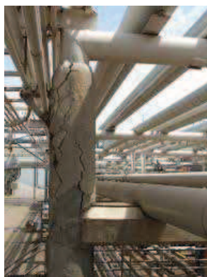
Ilustración 1. Revestimiento ignífugo agrietado o roto. Fuente: Thomas Kline. Fireproofing Fundamentals.
