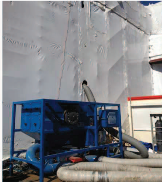
Ilustración 4. Aspirador de filtro móvil 20.000 m 3 /h.
