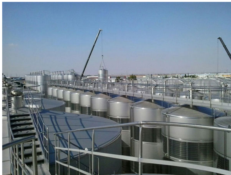
Fotografía de depósitos que contienen almacenado vino.
