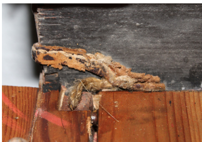
49. Detalle del excedente de remate de la forración externa.
