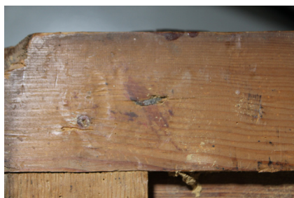
62. Detalle de la madera de una de las alas abatibles, donde se aprecia el considerable oscurecimiento de la madera.
