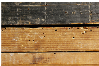
63. Detalle del ataque de insectos xilófagos en la zona de unión de dos paneles.
