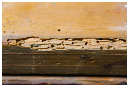
64. Detalle de faltante en una de las aristas de un panel, por el ataque de insectos xilófagos.
