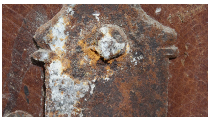
71. Detalle de los depósitos de sales presentes en las escuadras de la zona trasera.
