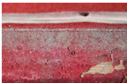
69. Detalle de la suciedad acumulada y los faltantes por el ataque de insectos xilófagos en el revestimiento interno.
