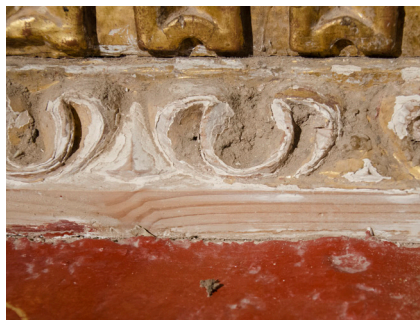
Figura 21. Soporte lígneo visible tras el desprendimiento de elementos ornamentales.
