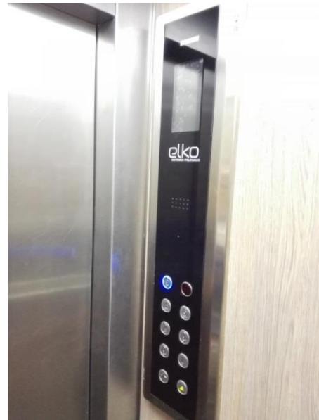
Figura 8. Botonera en funcionamiento
