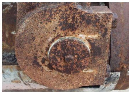
Figura 31: Detalle corrosión por punteado.
