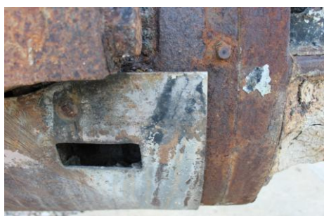
Figura 22: Diferencia entre la corrosión del hierro y del metal.
