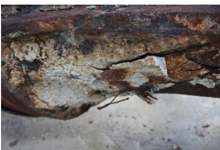
Figura 28: Detalle restos de hormigón.
