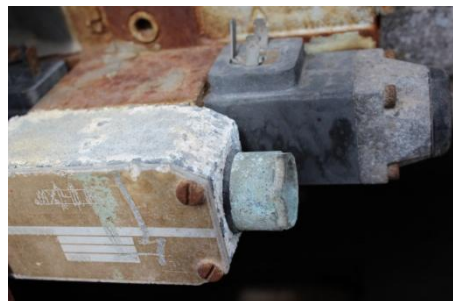
Figura 23: Detalle del motor.
