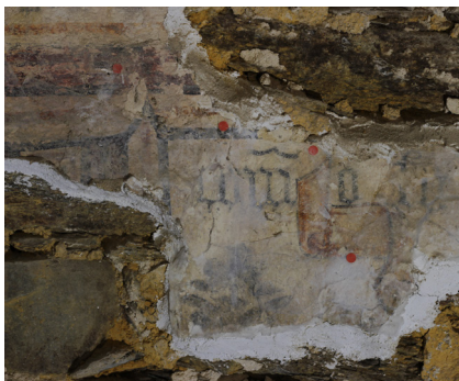
Fig.-20 Deterioro faltante
