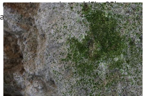
Fig.-23 Deterioro microorganismos
