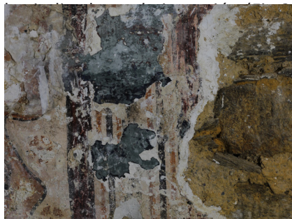
Fig.-22 Deterioro capa superior azul
