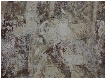
Fig.-21 Deterioro velo blanquecino
