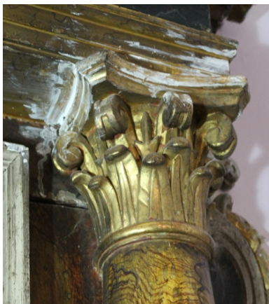
Figura 38. Imagen de depósitos de pintura blanca en el capitel.
