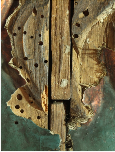
Figura 28. Detalle de madera encastrada y pérdidas.
