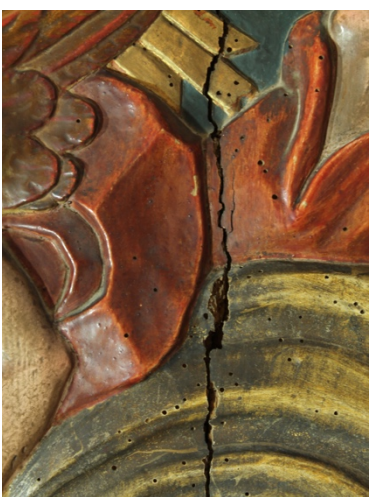
Figura 26. Detalle separación en las uniones.
