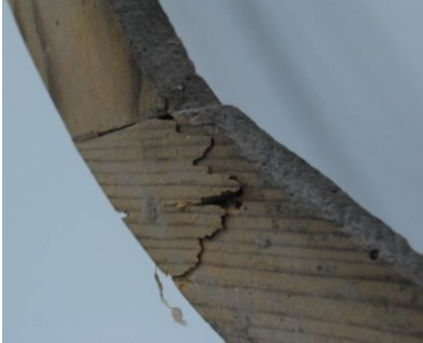
Imagen 56. Rotura en el bastidor
