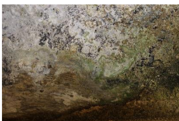
Fig.- 34. Vista exterior de inmueble: franja de musgo y líquenes en la parte inferior provocada por la humedad capilar.
