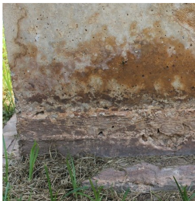
Figura 19. Detalle sales solubles (eflorescencias).
