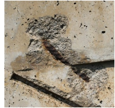
Figura 22. Corrosión de armadura y pérdida de hormigón II.
