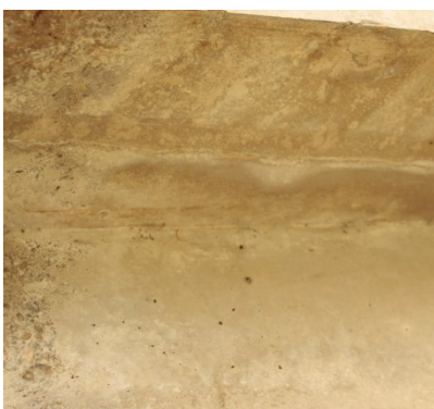
Figura 20. Detalle sales solubles II (eflorescencias).
