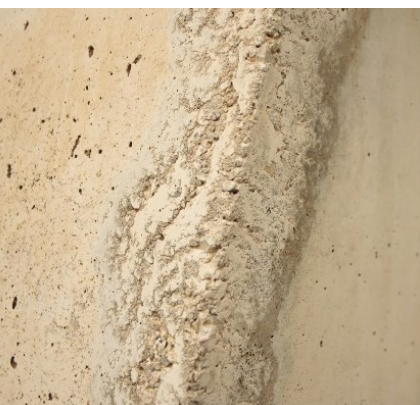
Figura 18. Detalle de disgregación.
