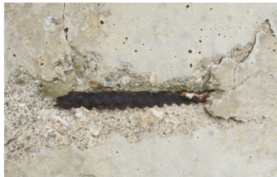
Figura 21. Corrosión de armadura y pérdida de hormigón.
