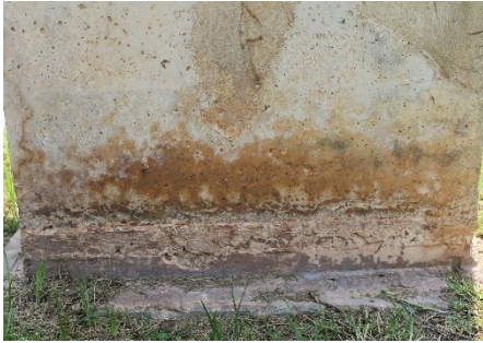
Figura 15. Detalle base de la pieza afectada por capilaridad.
