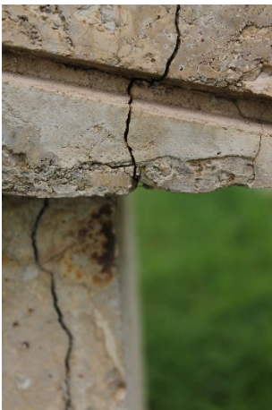
Figura 14. Detalle de grieta.
