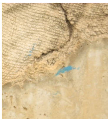
Figura 30. Mancha de pintura.
