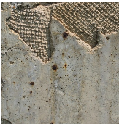
Figura 24. Manchas de corrosión en el hormigón.
