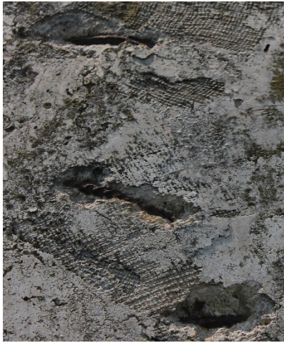
Figura 23. Corrosión de armadura y pérdida de hormigón III.
