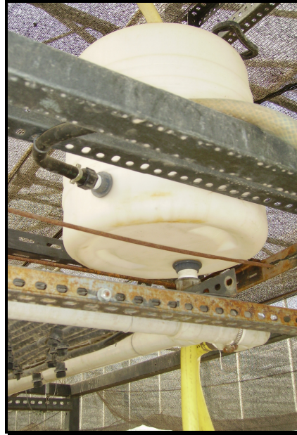
Figura 21. Deposito de agua
