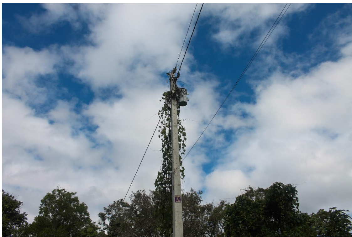
Fotografía 4. Tendido eléctrico en la comunidad de Angostura
