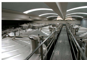
Fig.30. Instalaciones depósitos interiores
