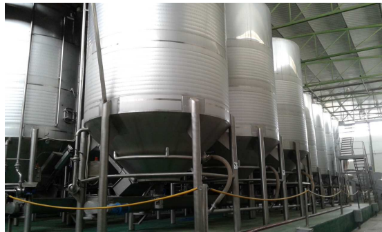
Fig.39. Depósitos interiores acero inoxidable.
