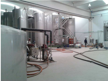
Fig.31. Instalaciones depósitos interiores
