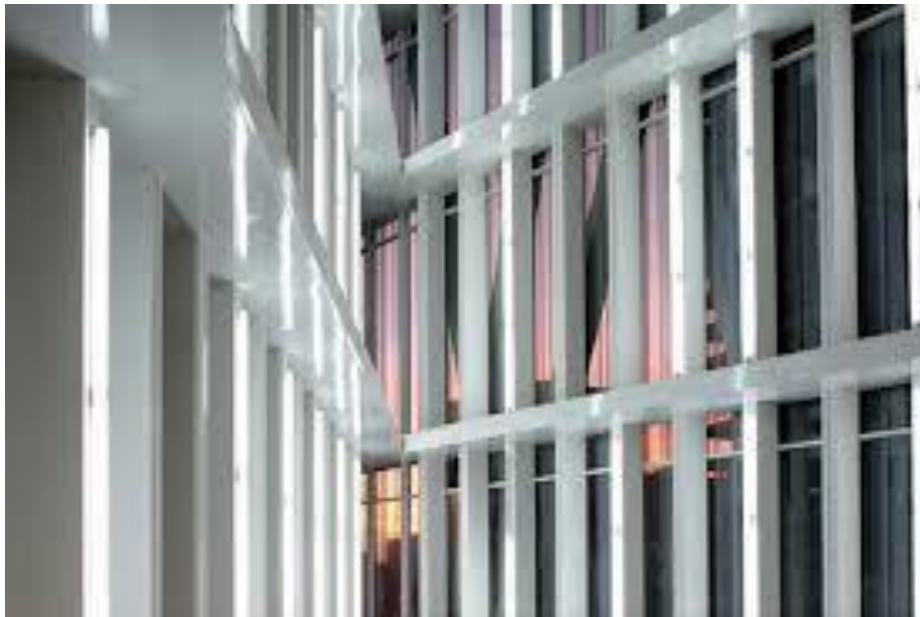
Imagen 4.1.3. Imagen interior de los soportes metálicos
