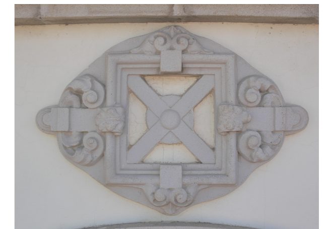
ORNAMENTO SUPERIOR EN VENTANAS DE AZOTEA
