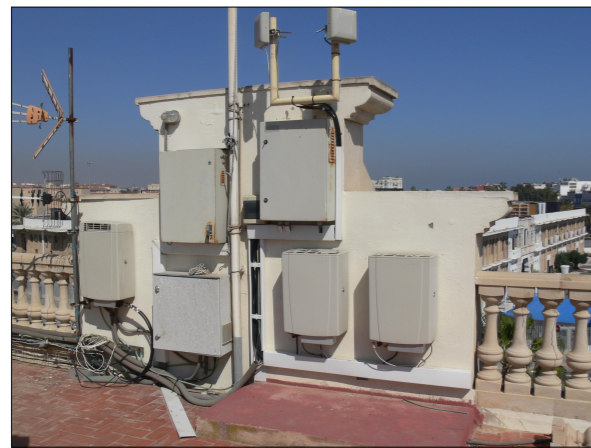
AZOTEA TRANSITABLE ESTADO ACTUAL
