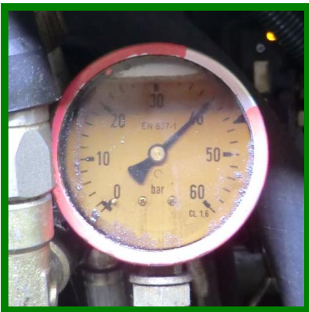
Fig 12. Manómetro marcado para una rápida inspección visual
