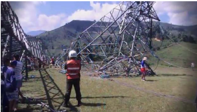
Imagen 32. Derrumbamiento de Antena de Red Eléctrica. Fuente: Betancur, 2013.
