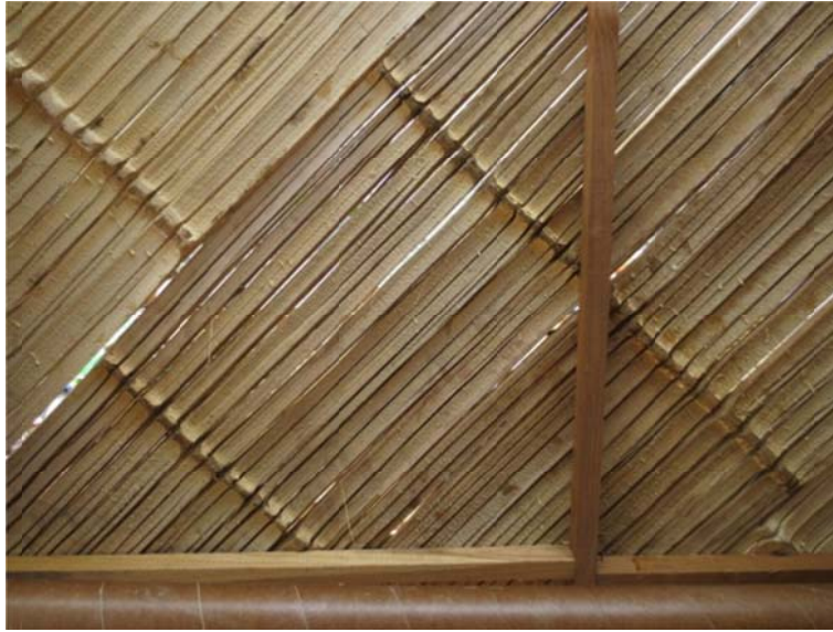
Fig. 24. Cerramiento de bambú para refugios de emergencia desarrollados por Shigeru Ban para Ecuador. (Fuente: Franco, 2016)
