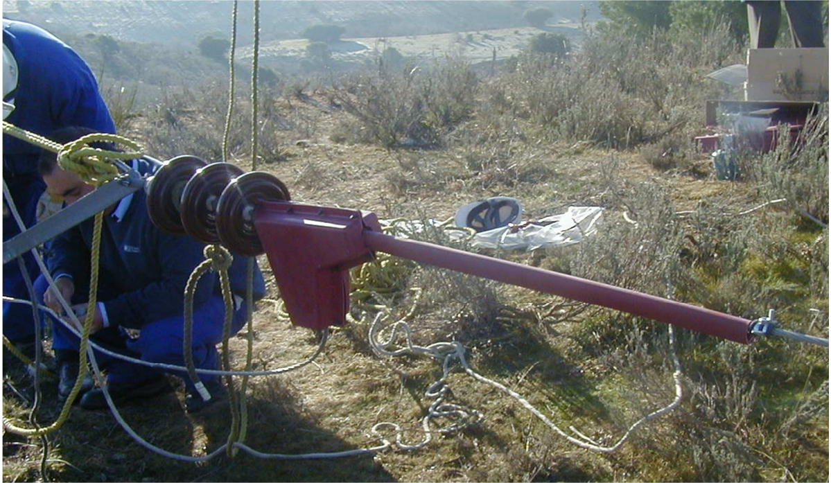
Ilustración 26: Detalle de protección antielectrocución en cadenas de amarre
