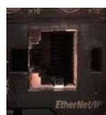
Ilustración 50. Conexión a Ethernet/IP del PLC
