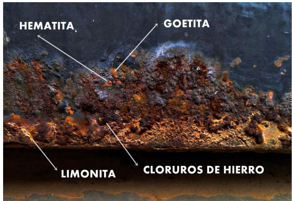
Fig. 19. Productos de corrosión presentes en la obra.
