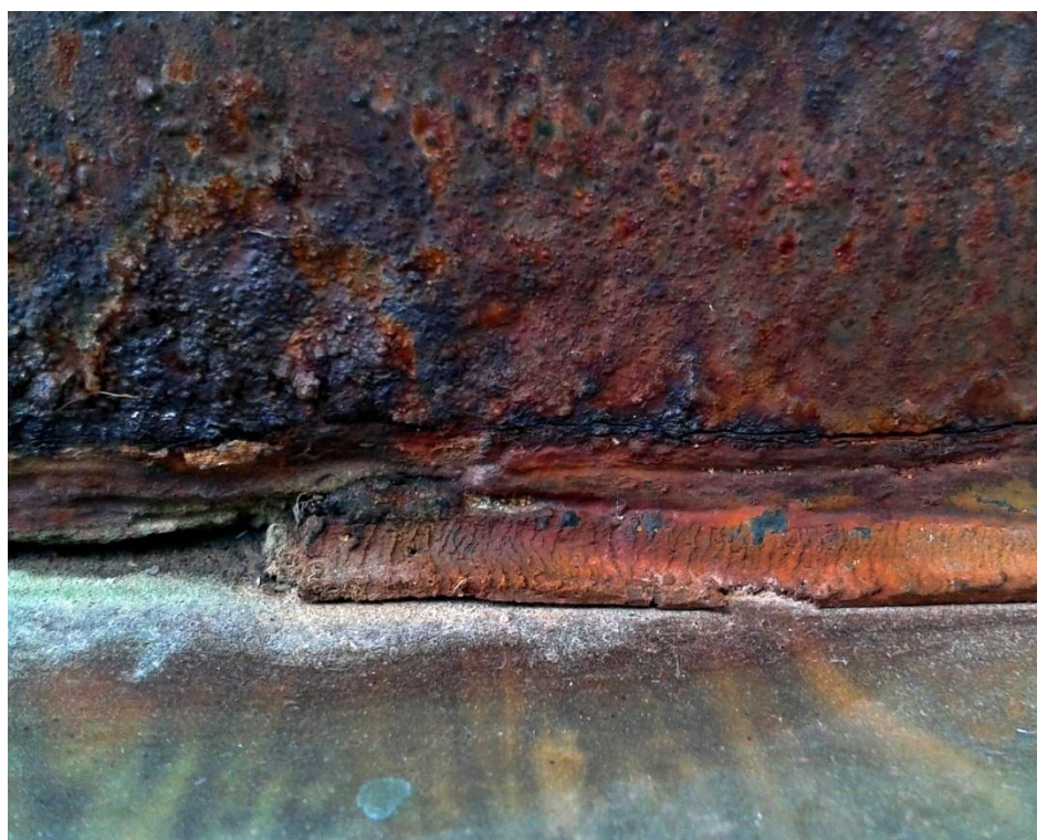
Fig. 16. Corrosión generalizada y fisura en la base metálica
