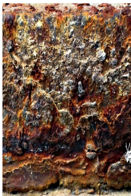
Fig. 17. Escorrentía de óxido en pedestal.
