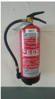
Ilustración 37. Extintor existente en el edificio 1B de Polvo
