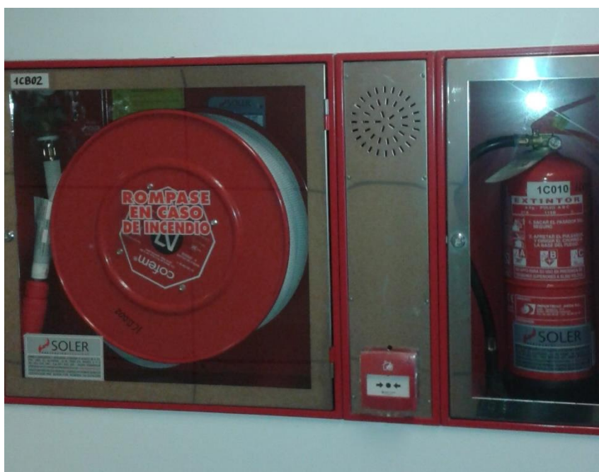
Ilustración 38. BIE Edificio 1C
