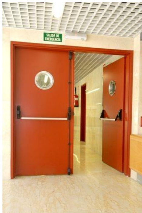
Ilustración 6. Puerta cortafuego (imagen de libre acceso web)
