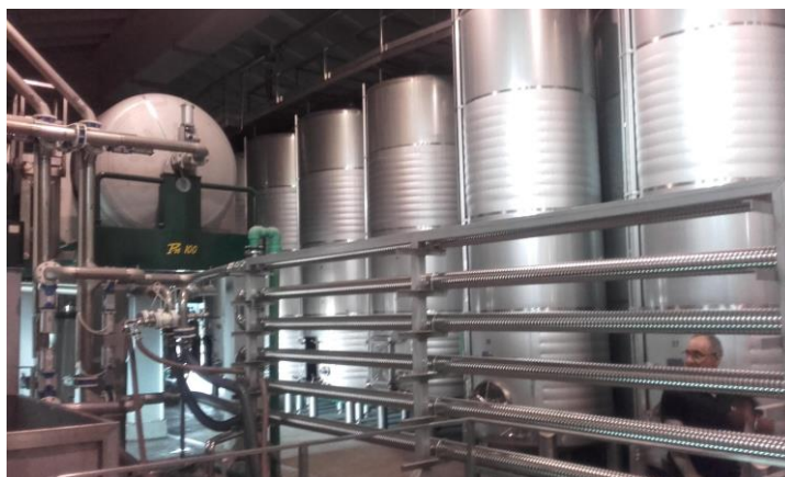
FIGURA 23. TANQUES DE VINO
